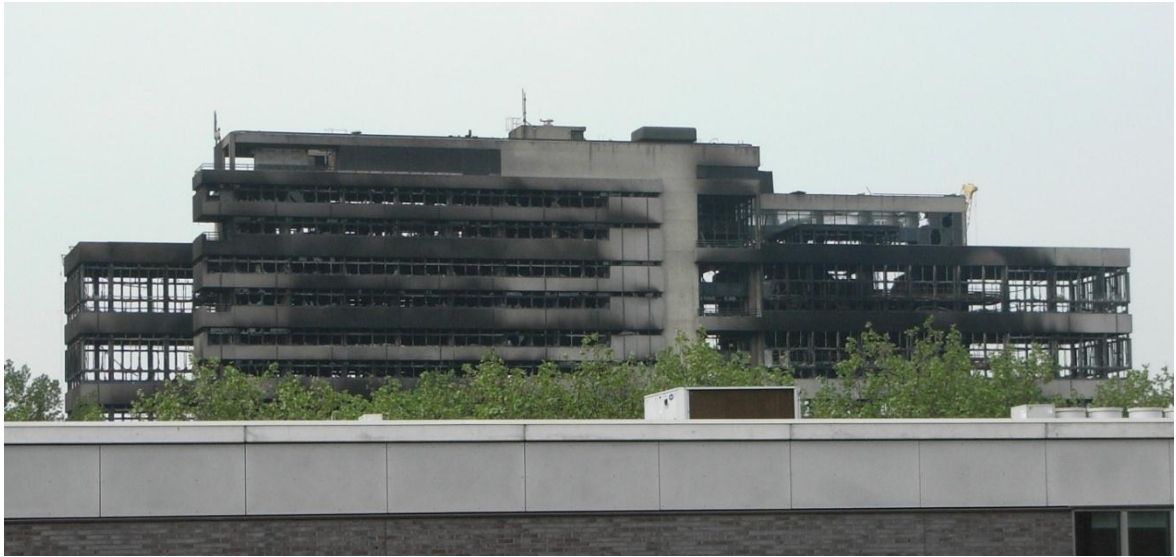
Figuur 13: Het uitgebrande gebouw van de faculteit Bouwkunde van de TU Delft (mei 2008). Door falende compartimentscheidingen kon de brandomvang zo groot worden dat dit heeft geleid tot hoge brandtemperaturen en een lange brandduur. Daardoor is uiteindelijk ook een deel van de hoofddraagconstructie bezweken. Het gebouw moest daardoor worden gesloopt.
