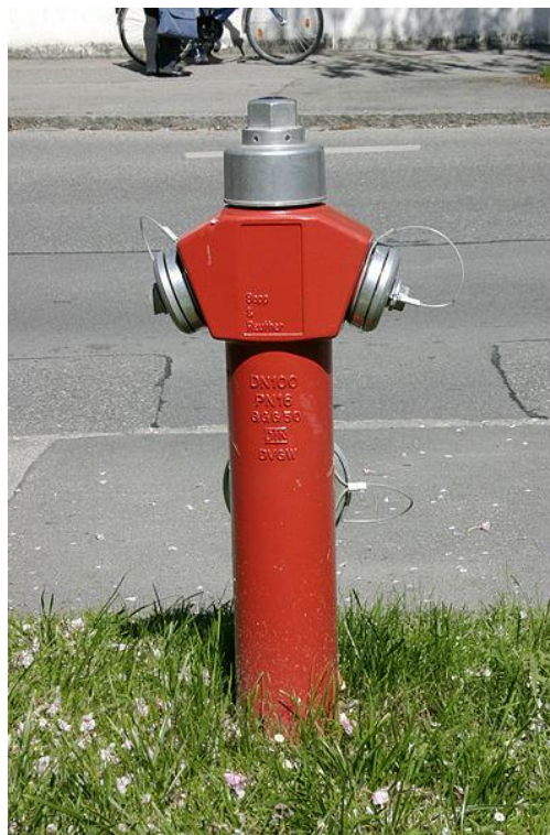
Figuur 8: Bovengrondse hydrant
