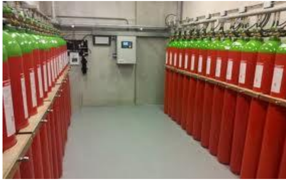
Figuur 11: Cilinderbatterijen met verzamelleidingen.
