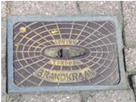
Figuur 6: Ondergrondse hydrant
